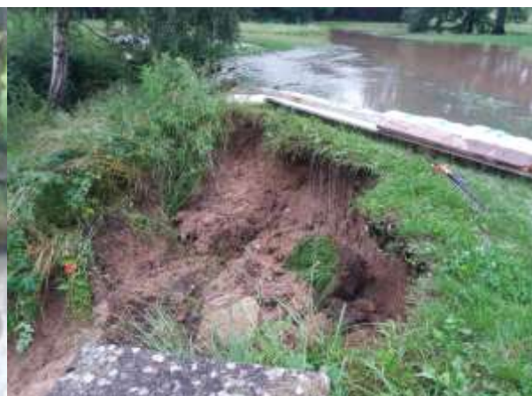
Détérioration talus aval haricot du Perray
